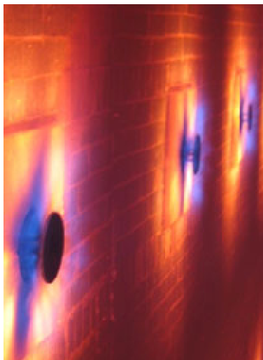
Obr. 6 Nahřátá stěna pece se sálavými stěnovými hořáky [28].
