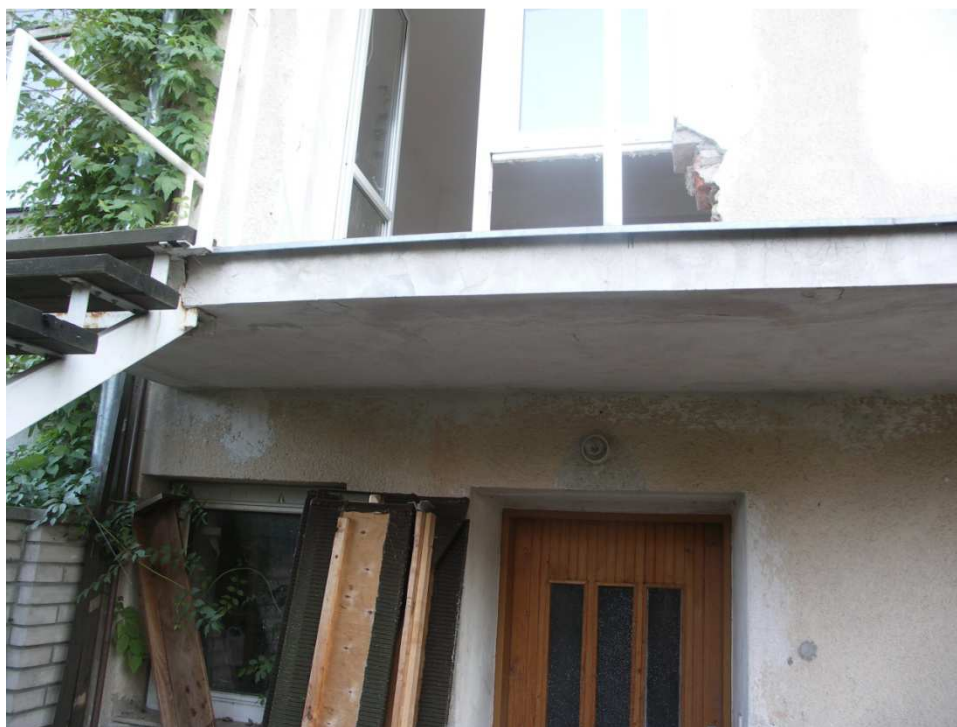
Detail posuzovaného překladu nade dveřmi v přízemí
