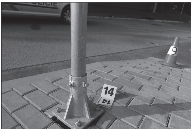
Obr. 3 Částečně vyvrácený sloupek dopravní značky (zdroj: PČR). Fig. 3 Partially displaced traffic sign jamb (source: police).
