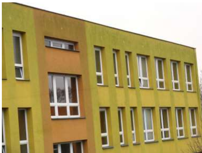
Obr.2 – Biotické napadení posuzovaného objektu
