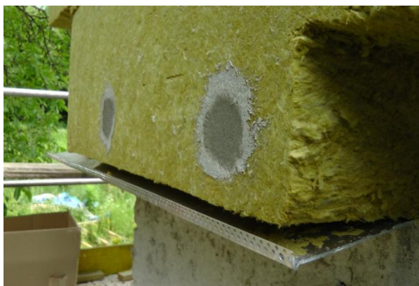
Obr. 2 – fotografie autor – chyby při realizaci Fig. 2 – photograph author - mistakes at realization
