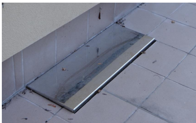
Obr. 4 – fotografie autor – chyby při realizaci Fig. 4 – photograph author - mistakes at realization
