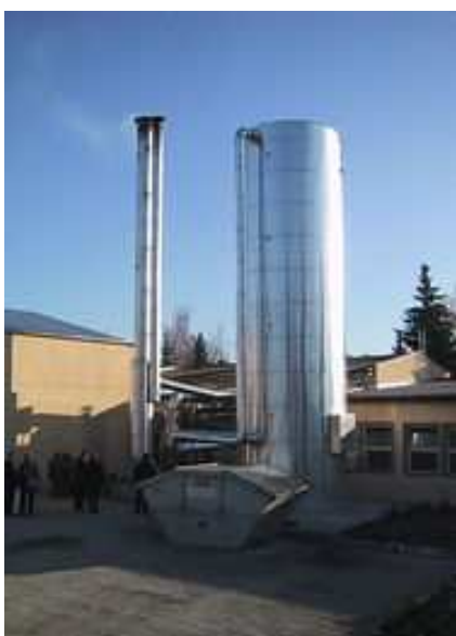
Obr. 2.3.1 Kotelna s komínem a akumulátorem tepla
