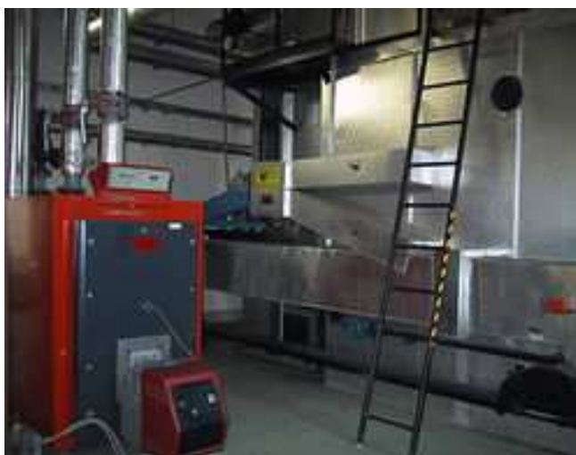
Obr. 2.3.3 Záložní kotel na LTO (vpravo), kotel na slámu (vpravo)
